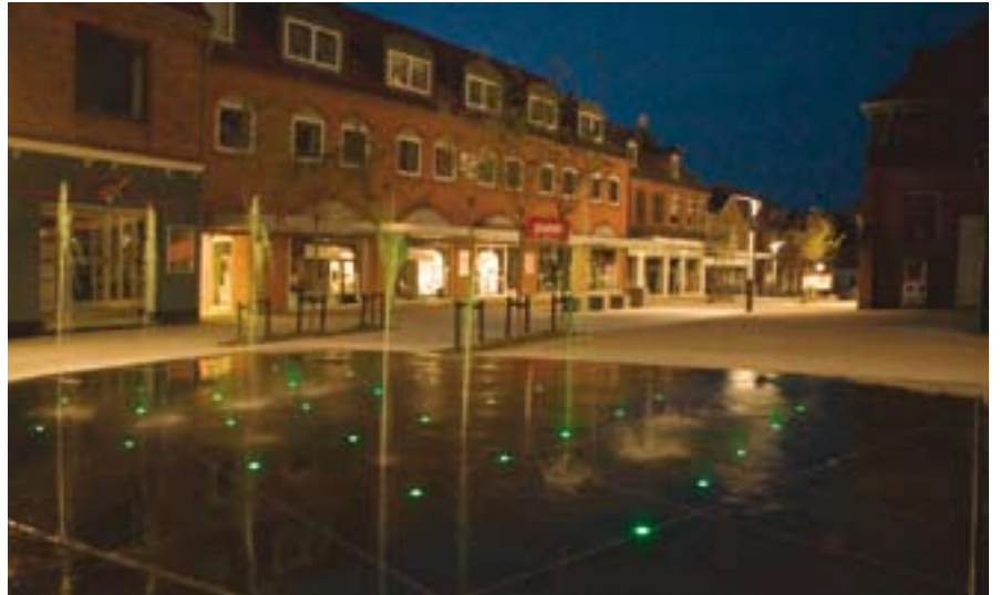
I springvandsscenen er der monteret fiberlys til oplysning af vandstrålerne. Derudover er der fiberlys under scenekanten. Foto: Philips Lighting.
